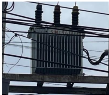
Gambar 4.1. Trafo Distribusi 100 kVA (Sumber : PT. PLN Area Ambon, 2023)
